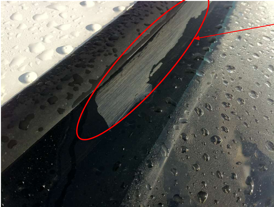
De-bonding of Primer
